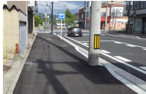
電線共同溝本体工事(完了後) ※歩道部舗装の美装化及び抜柱は 次年度以降に施工予定
