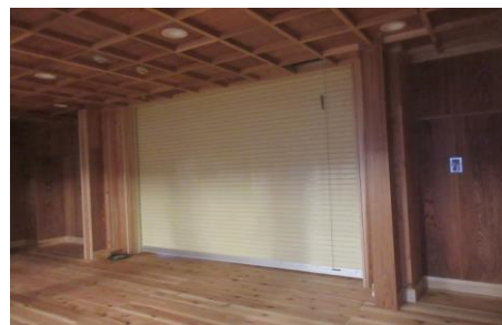
防火設備設置(防火シャッター)
